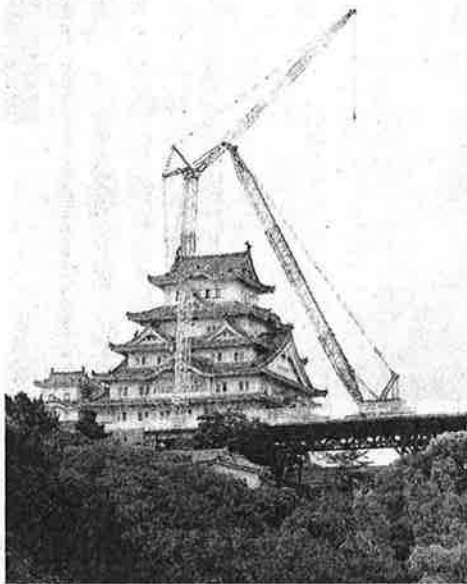
姫路城に設置された2台目の大型クレーン(左)―姫路市本町で
